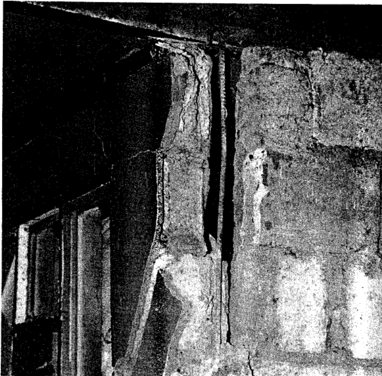
Foto 6. Sólo una varilla como refuerzo esquinero y sin viga corona: el resultado es obvio. (Puriscal, 1990)
