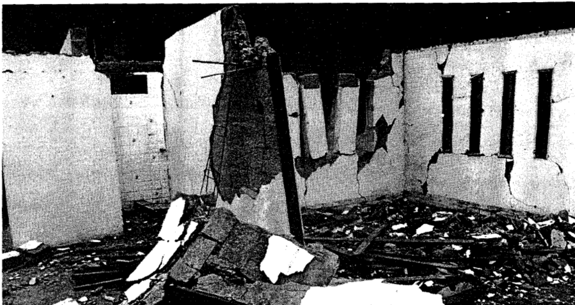
Foto 10. Se nota concreto de mala calidad, falta de refuerzo en la pared de mampostería y los aros están muy distanciados en la viga corona. (Puriscal, 1990)
