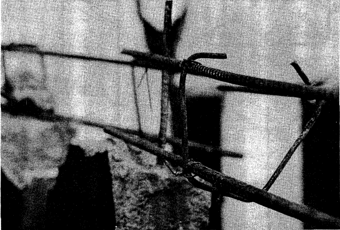
Foto 12. En esta viga corona se revelan fallas como aros abiertos por confección incorrecta y muy distanciados y empalme incorrecto. (Puriscal, 1990)
