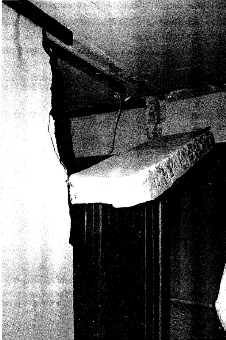
Foto 11. Falla del cargador por falta de refuerzo. (Purişcal, 1990)
