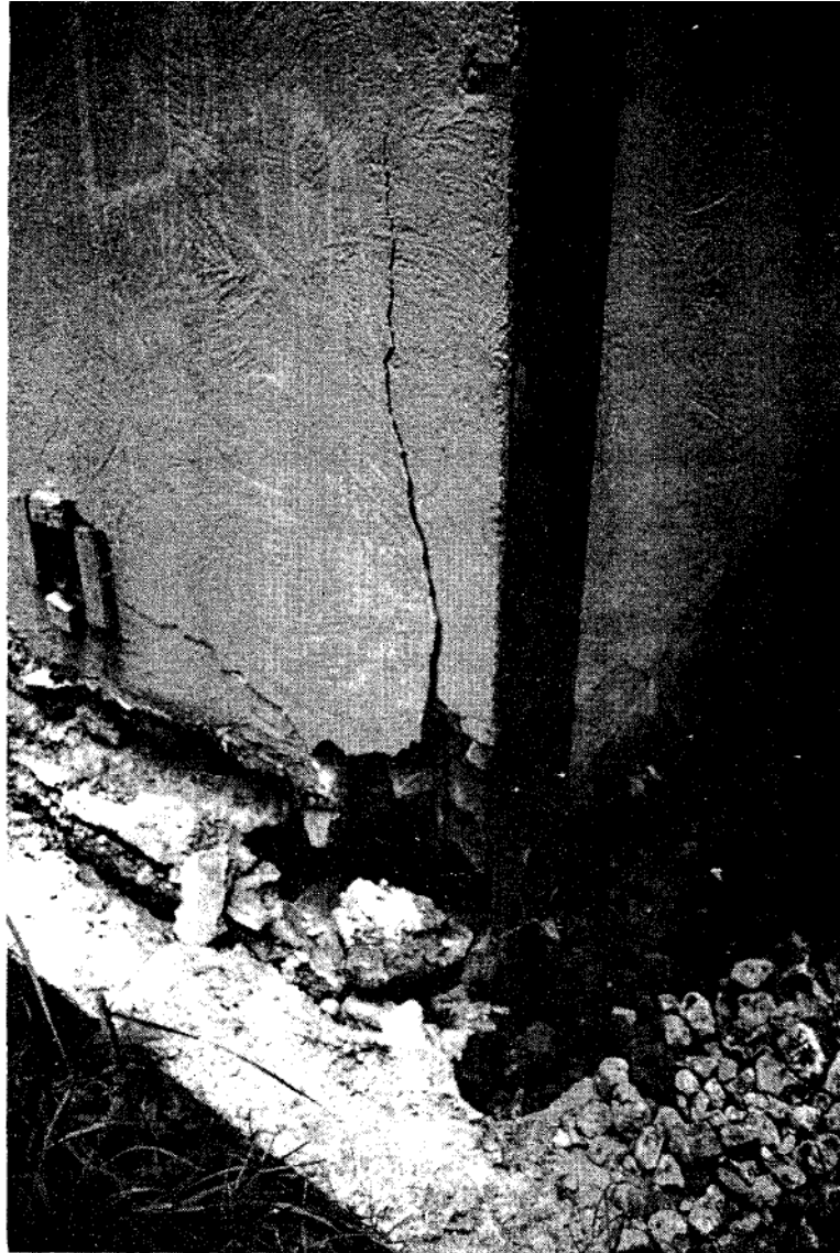
Foto 13. Falla de cemento por mala compactación del terreno más socavación por aguas mal encausadas. (Puriscal, 1990)
