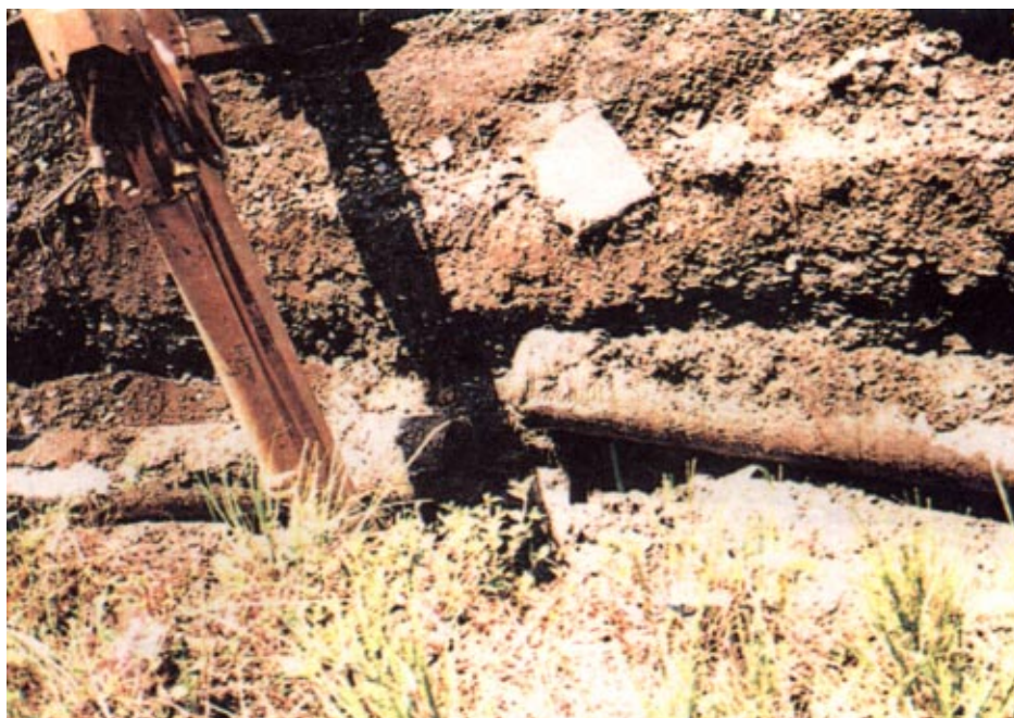
Fotografía 8.6 Daños en la tubería de concreto de 500 mm
