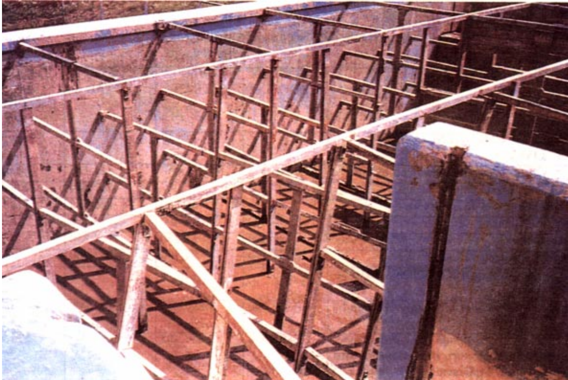
Fotografía 8.1 Daños en los floculadores de la planta de tratamiento
