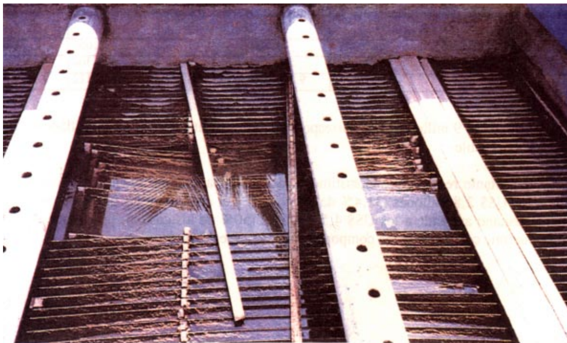
Fotografía 8.2 Daños en los sedimentadores de la planta de tratamiento
